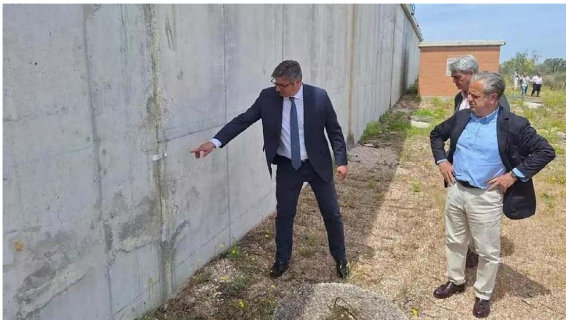
El alcalde de Puente Genil, Sergio Velasco, señalando una de las paredes del depósito que filtra el agua de la localidad. / CÓRDOBA
